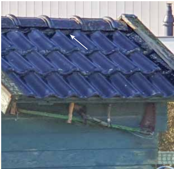
Figuur 9. Het kleine hokje met dichtgemetselde nokpannen.
